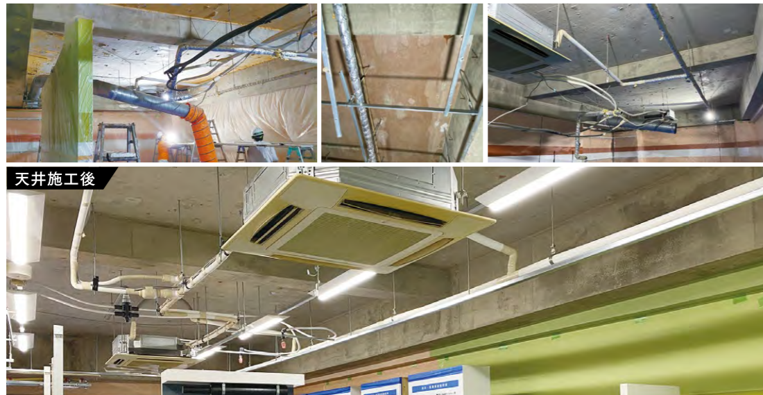
天井は天井ボードを剥がし、実際の配管が見えるように施工しました。
