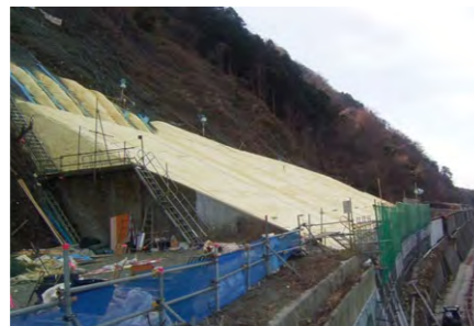
ロックシェッド(土砂崩防止)
