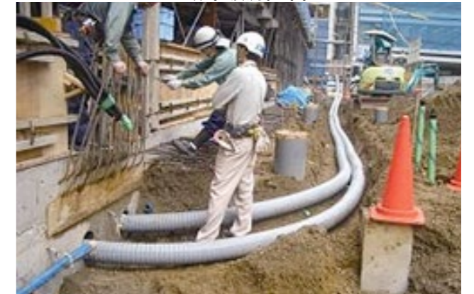
地域冷暖房配管
