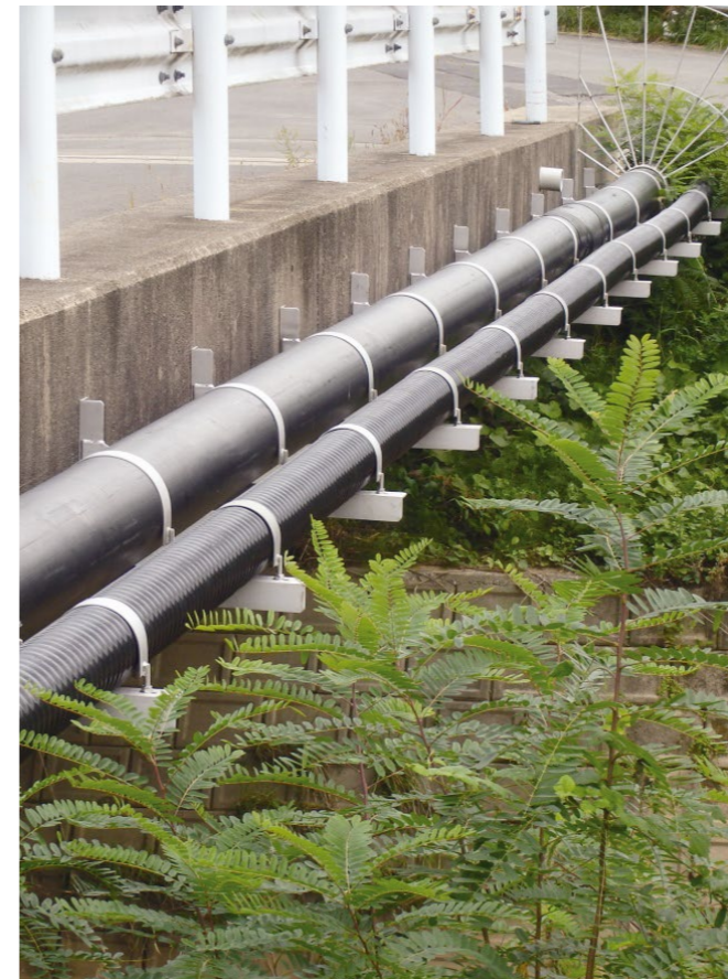
上下水道ダブル配管
