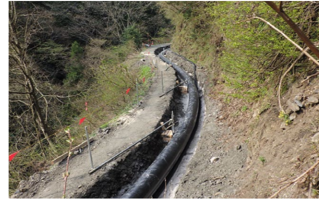
小水力発電送水管
