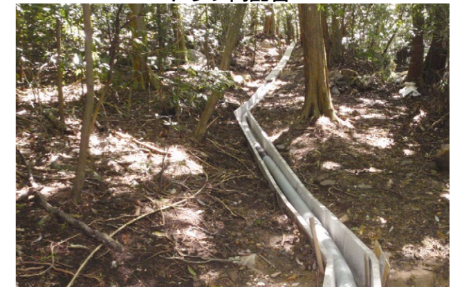
トラフ内配管
