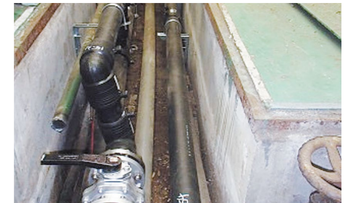
圧縮エア配管
